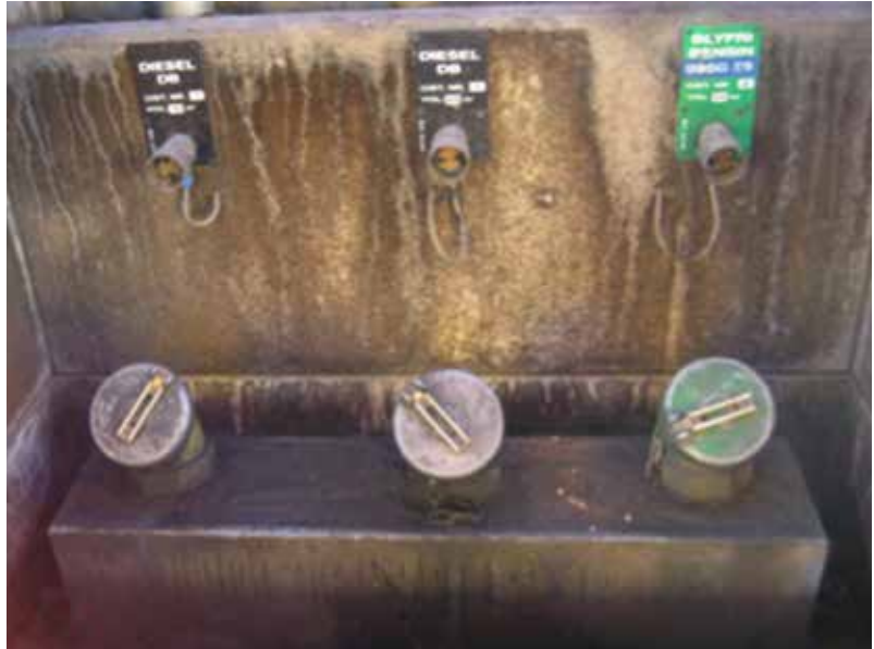
Anslutningar på bensinstation
