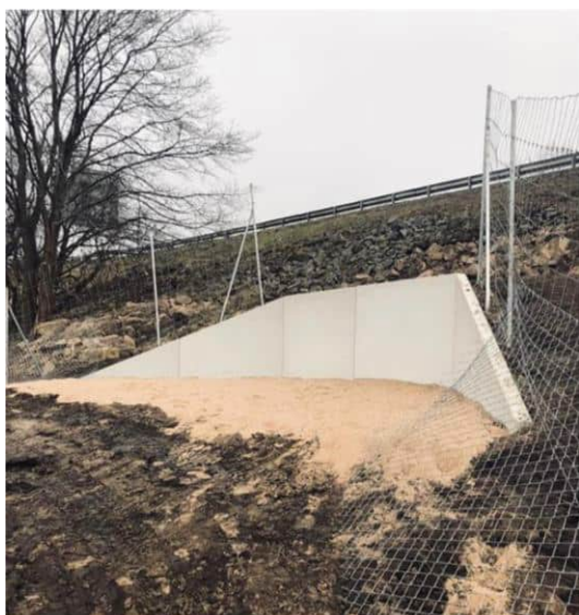
Figur 5.2:6 Exempel på viltuthopp väg 23 Tjörnarps-Sandåkra. Källa Trafikverket.
